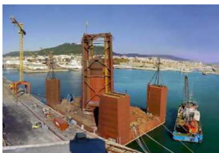
Prototipo 2 MW Archimede Wave Swing (AWS) antes de su fondeo en aguas próximas a Oporto
